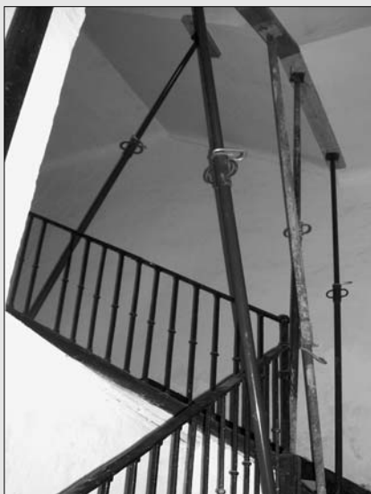
Das Treppenhaus: Nach dem Bau einer Tiefgarage auf dem Nachbargrundstück senkte sich das Kirchengebäude ab.
